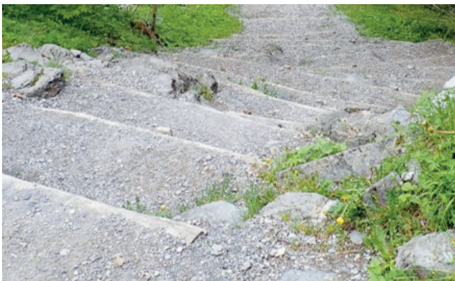
Auftriebsweg Surenen vor der Sanierung: Für die 500 Rinder, die hier in kürzester Zeit passieren müssen, bildeten die Treppe und die Brücke ein Nadelöhr mit erhöhter Verletzungsgefahr.
