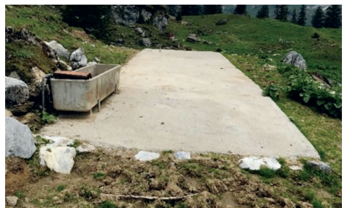
Sanierte betonierte Tränkestelle.
