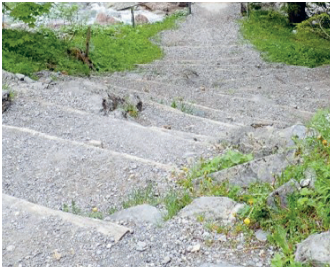
Auftriebsweg Surenen vor der Sanierung: Für die 500 Rinder, die hier in kürzester Zeit passieren müssen, bildeten die Treppe und die Brücke ein Nadelöhr mit erhöhter Verletzungsgefahr. Agrofutura
